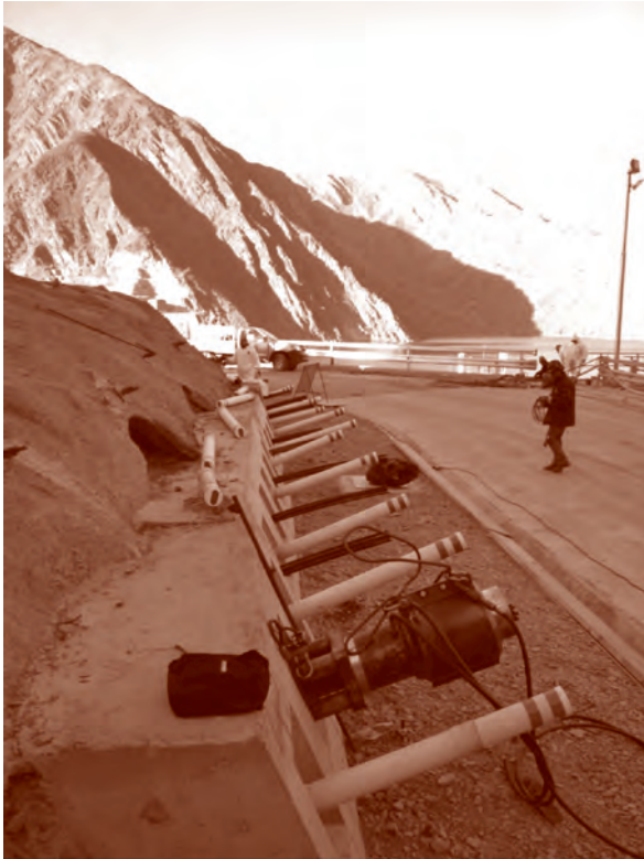
FIGURA 4. CABEZALES DE LOS ANCLAJES PERMANENTES DE LA PRESA CARACOLES
