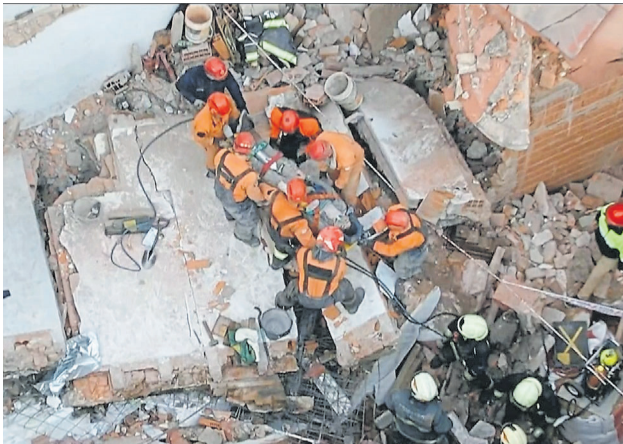
ESCOMBROS. Los derrumbes y colapsos durante la construcción de obras se han hecho más frecuentes.
